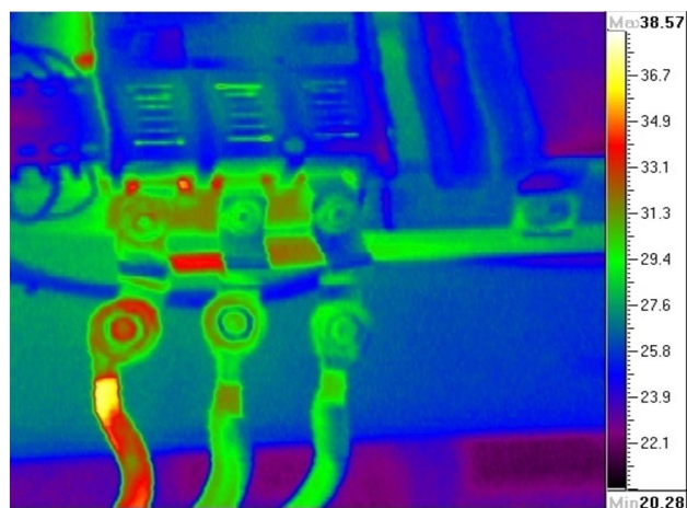
Рисунок 21. Пример термограммы контактных соединений с температурной шкалой
