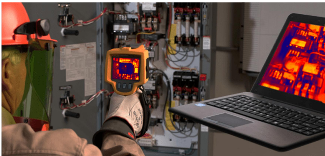
Рисунок 20. Пример проведения тепловизионного контроля электрошкафа
